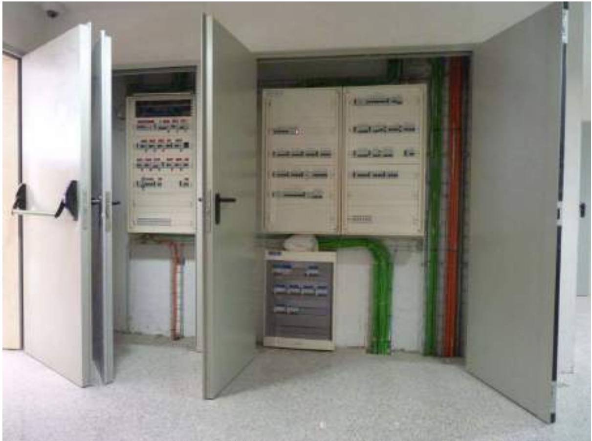
Fotos 101-103: Conducciones Electricidad; Patinillo entre plantas y por Techo Garaaje:
